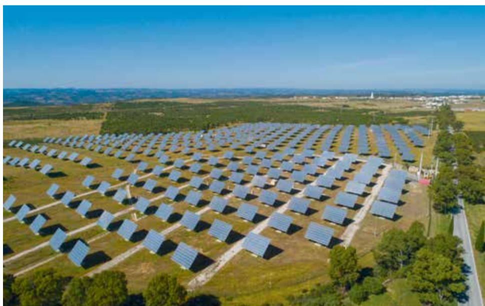
Central Fotovoltaica de Martim Longo | Maio de 2020
